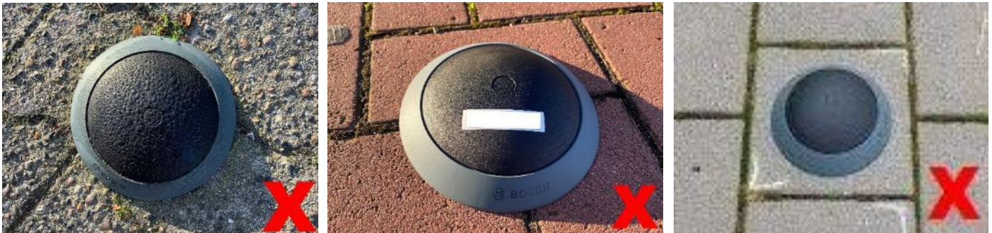
Illustration 7 Exemple d'une installation non conforme
