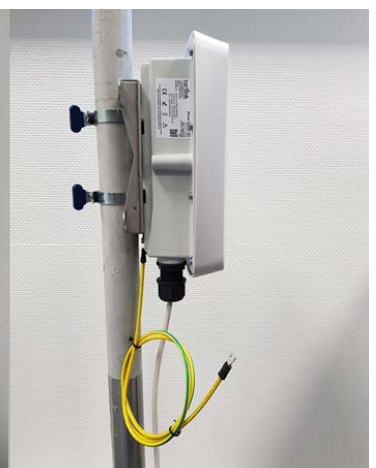
Installation der Wirnet™ iStation auf dem Ständer
